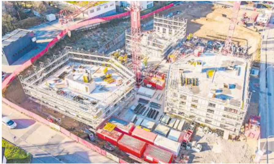
Um der künftigen Nachfrage gerecht zu werden, braucht es im Fricktal mehr Wohnraum – hier entsteht in Frick die Überbauung Stöcklimatt. Bild: Paul Gürtler
